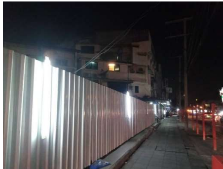
รูปที่ 12 ซ่อมแซมผิวถนนและทางเท้า และติดตั้งไฟส่องสว่างบนทางเท้าเพิ่มเติม
