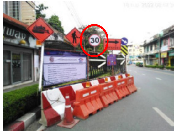
รูปที่ 2-18 การติดตั้งป้ายเตือนความเร็วบริเวณเขตพื้นที่ก่อสร้าง
